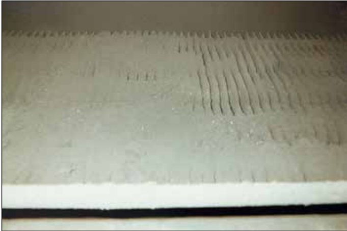
Economizer-Bereich nach einem Monat Betrieb ohne Schallreinigung. Der ganze Kessel musste stillgelegt werden.
