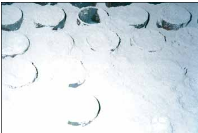
Luft-Vorwärmer nach vier Monaten Betrieb ohne Schallreinigung. Der ganze Kessel musste stillgelegt werden.
