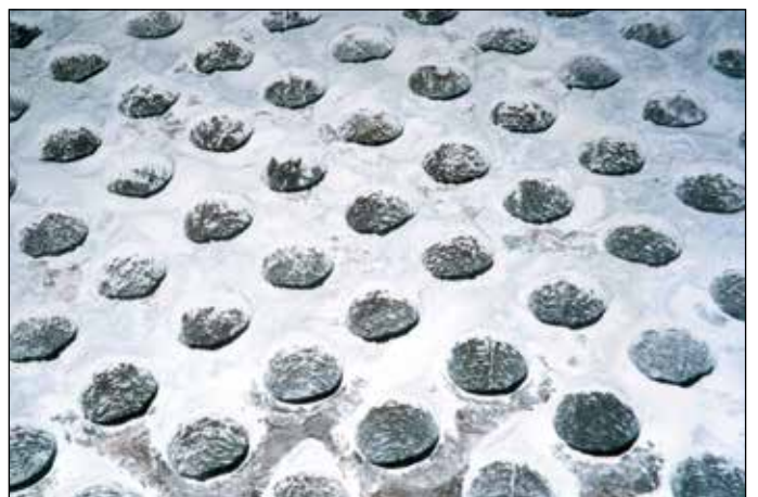
Luft-Vorwärmer nach vier Monaten Betrieb mit Schallreinigung.
