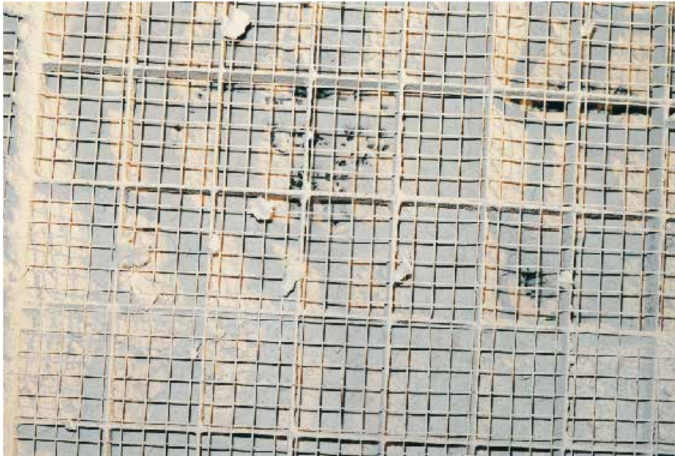
SCR-Katalysator, nach sechs Monaten Betrieb ohne Schallreinigung
